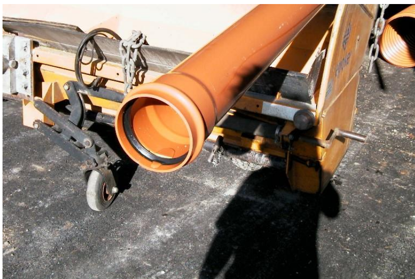
Spillvannsrør i PVC.
