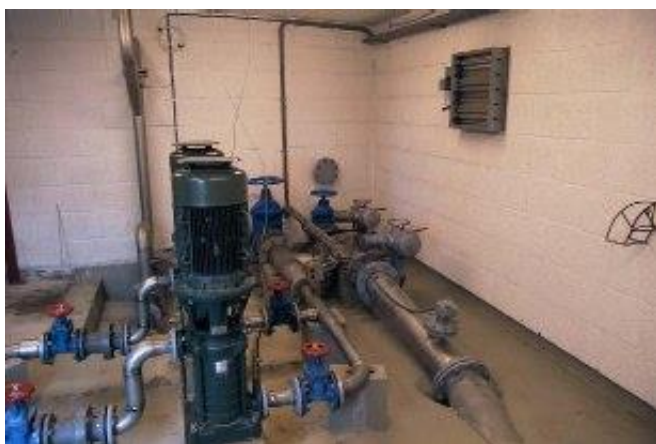
Plasstøpt trykkøkningstasjon for vann. Grøndokka trykkøkning er sammenbygd med vannbassenget. Bildet viser to stk pumper som regulerer m3 vann etter behov.
