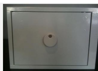
Beskyttelse over nøkkelhull, det har forekommet at den er montert opp/ned
